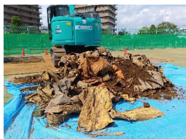
沈下の原因となった埋設物
