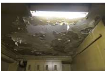
図 2-77 下足室（西）雨漏り
