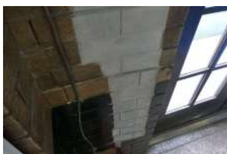
図 2-75 公会堂タイル割れ補修跡
