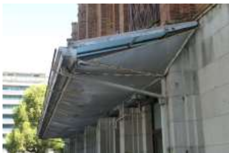
図 2-68 公会堂底ガラス割れ（ネット養生）
