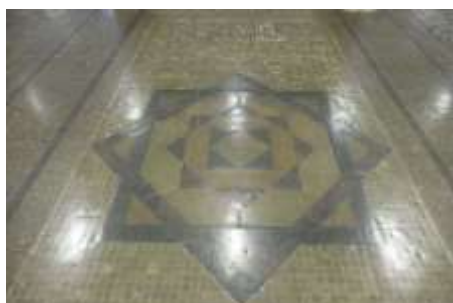
図 2-72 公会堂テッセラー仕上げ汚損
