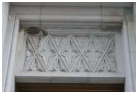
図 2-71 横根澤石 雨染み、表面劣化
