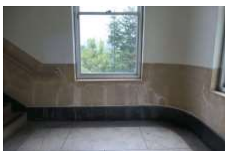
図 2-74 公会堂人造石研出し腰壁クラック
