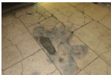
図 2-73 公会堂階段室床テラゾー剥離
