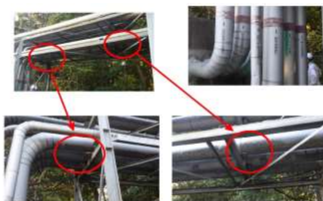
写真 17 清掃工場側での高温水の漏水発生
