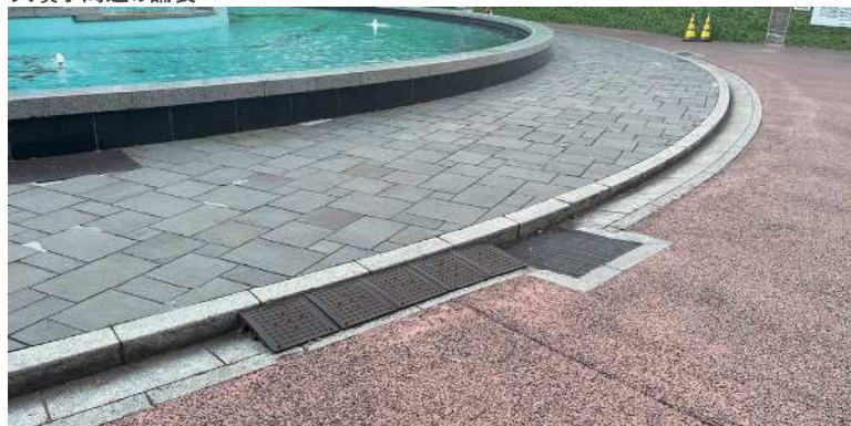
大噴水周りの舗装に排水のための段差があり、バリアフリーの対応が十分でない状況です。
