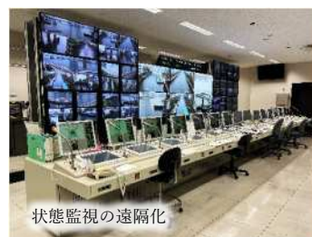
写真2 水門管理システム
