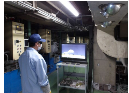
排気口のモニタリング
