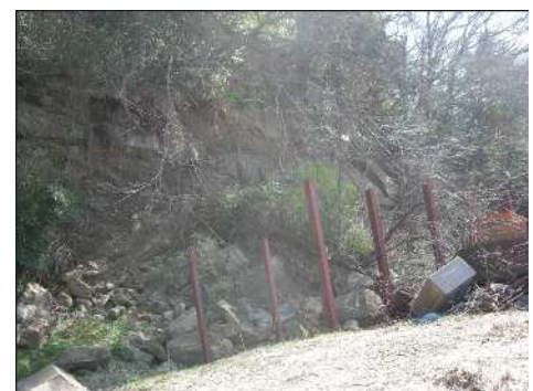
写真－1 土砂崩落
