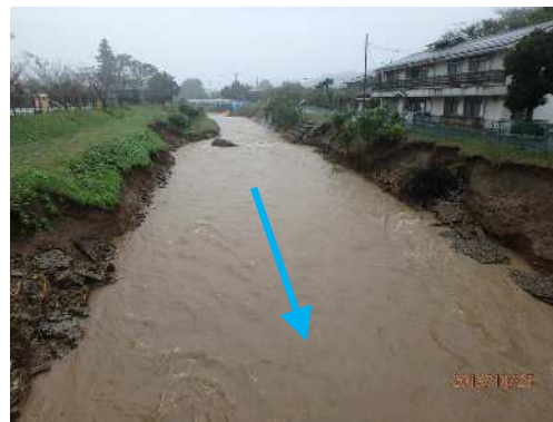
R元.10月 堀口橋上流両岸崩壊
