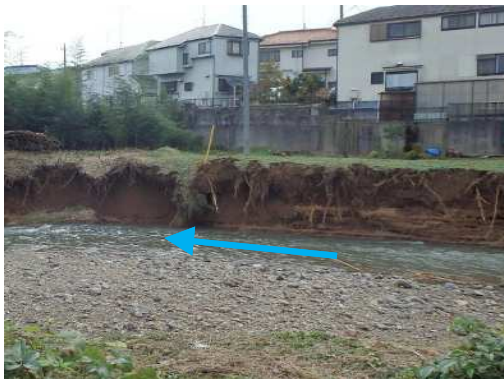
H29.10月 堀口橋下流右岸崩壊
