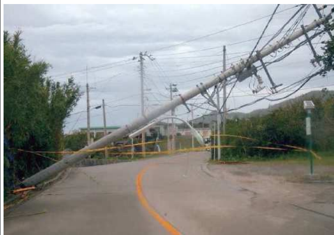
令和元年台風15号の影響による電柱倒壊(新島村若郷地区) (出典：パンフレット「東京の無電柱化(東京都)」)
