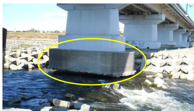
写真1 橋脚の基礎が突出状態となった時の状況
