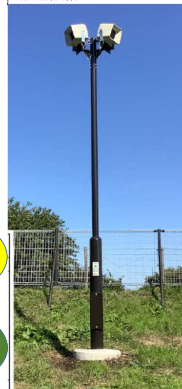
放送設備（スピーカー）
