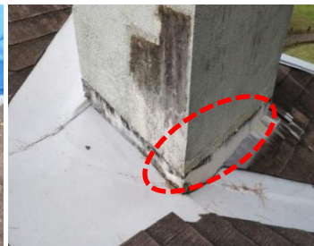
室内の雨染みから劣化が明らかになった煙突の漆喰
