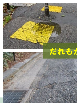
園路の不陸（施工前）
