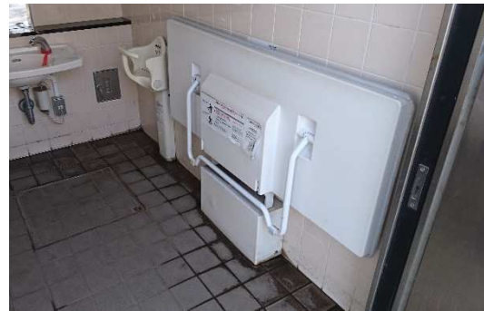
写真2 大きめのベッド 保護者等から要望の多い設備である。(都立亀戸中央公園)
