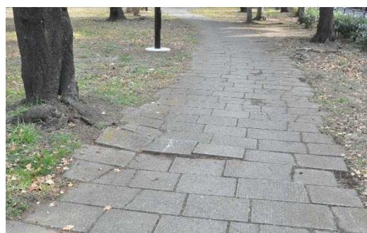
写真2 根上りによる園路の凹凸 樹木の近くに園路を通す場合、根上りに注意する。(都内公園)
