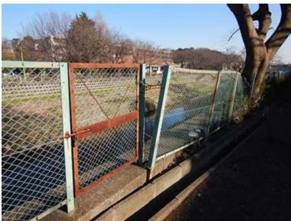
転落防止柵の破損（野川）
