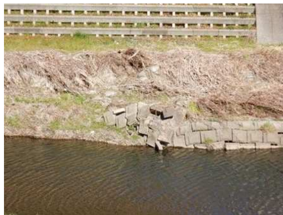
破損、損傷（野川）
