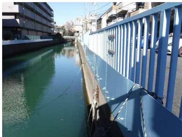
溢水防止板（立会川）
