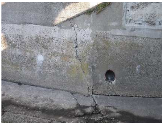
ひび割れ（立会川）
