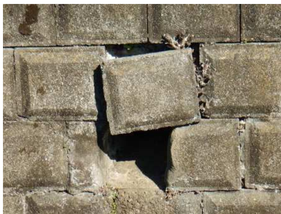
ズレ、損傷（目黒川）
