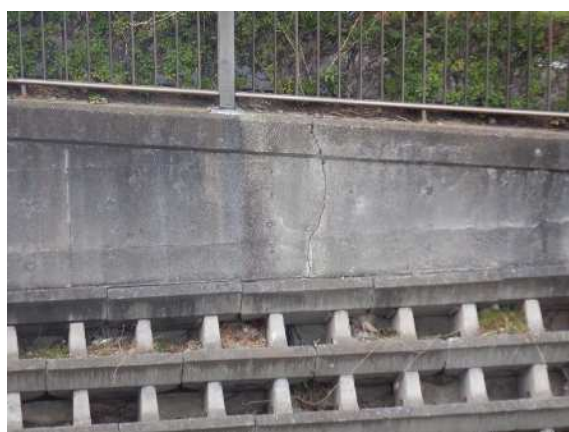
ひび割れ（野川）
