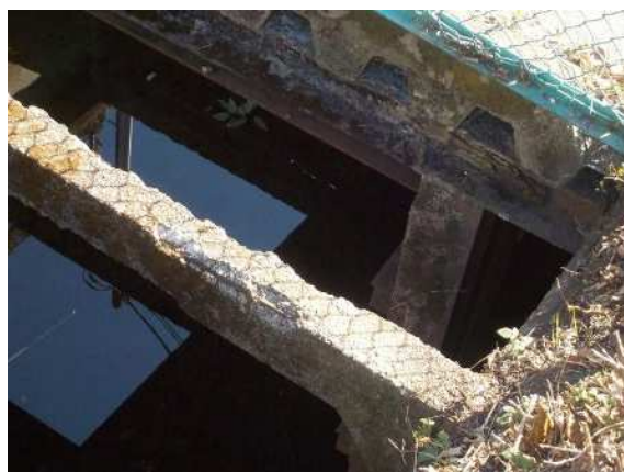
剥離、損傷（丸子川）
