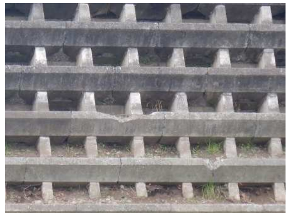
植栽ブロックの破損（野川）
