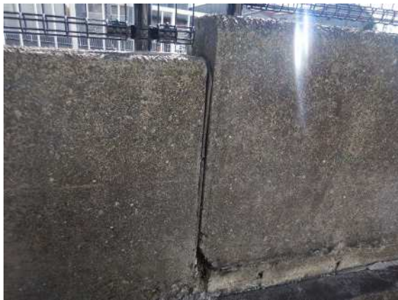
継目の段差（呑川）
