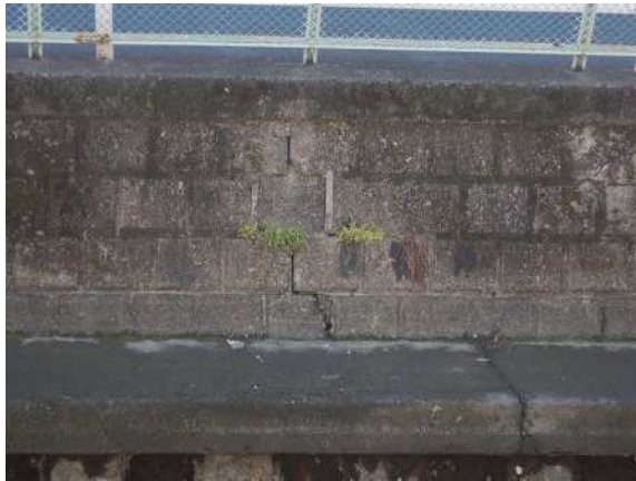
ひび割れ・目地開口（内川）
