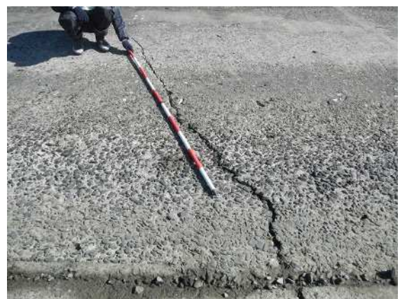
ひび割れ（海老取川）
