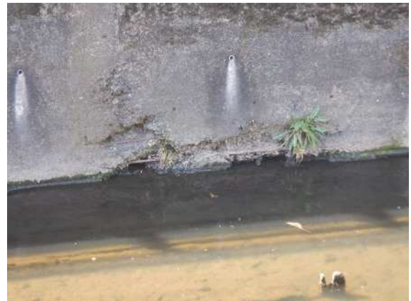
剥離・損傷（仙川）
