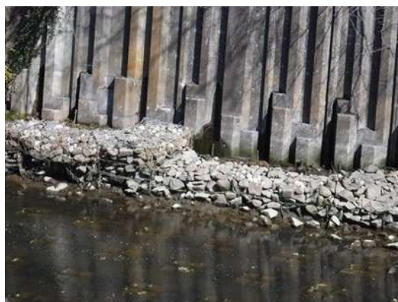
根固工の破損（目黒川）
