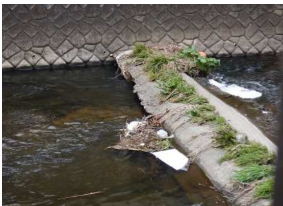
床止工の破損（仙川）
