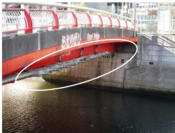
高度処理水の放水（目黒川御成橋 芝浦水再生センター）
