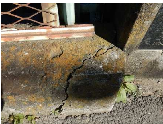
ひび割れ（丸子川）
