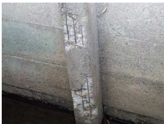
剥離、損傷（丸子川）
