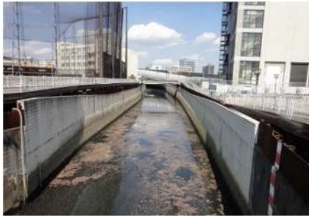
石神井川 スカム発生状況
