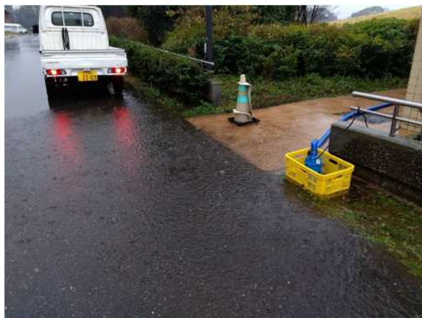
写真6 これまでの排水ポンプ対応時
