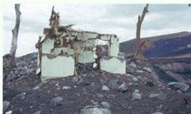
三宅島 1983年噴火 噴石によって破壊された建物 (世界の火山図鑑, 須藤茂著)
