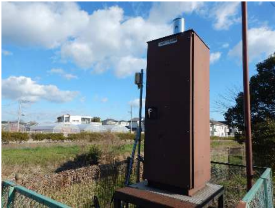
雨量及び水位観測所
