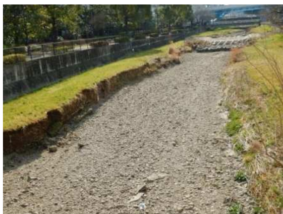
水涸れ状況（第二天王橋）
