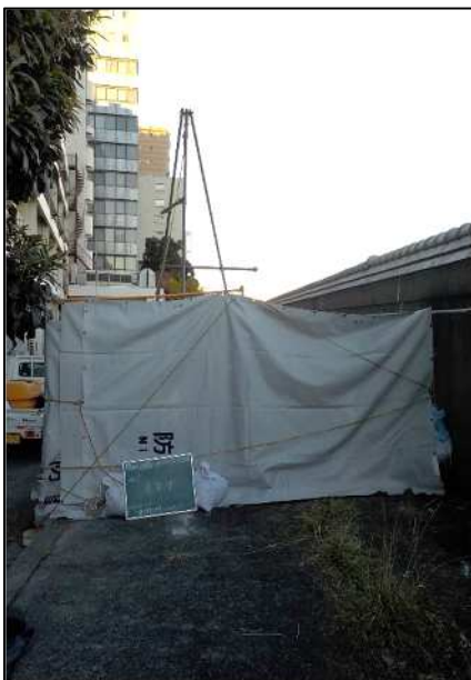
【騒音対策施設設置状況】
