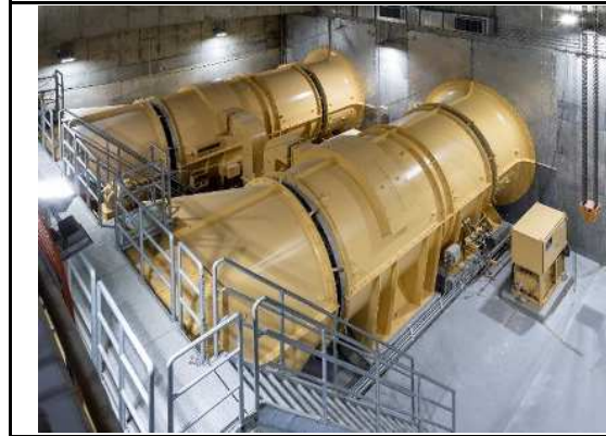
排風機設置状況
