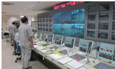
水門管理システム
