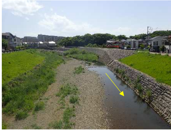
写真 2-2 護岸の整備状況（清瀬市中里）
