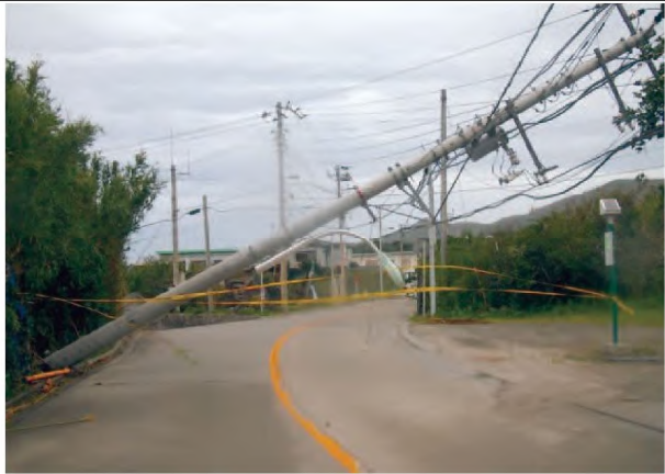
令和元年台風15号の影響による電柱倒壊（新島村 若郷地区）
