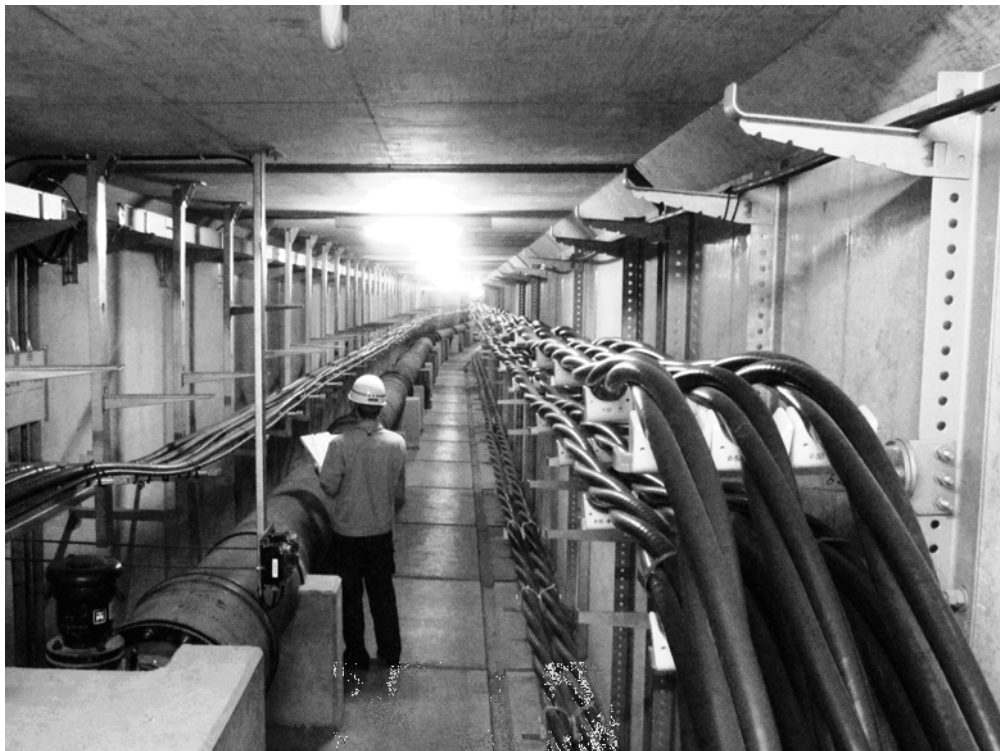
立川共同溝内部
