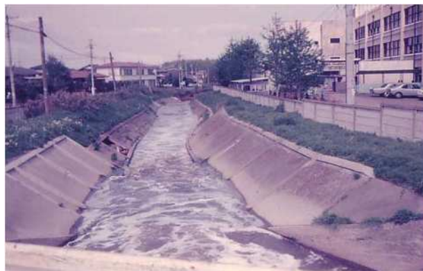
写真 2-7 汚濁が著しい頃の空堀川(昭和 50 年代)
