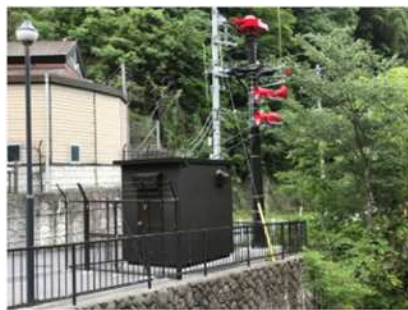
▲ダム放流警報設備
