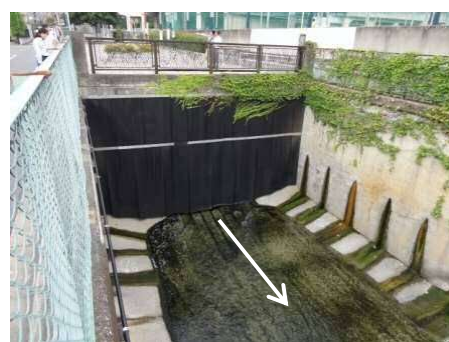
下水道再生水の導水(工大橋付近)
