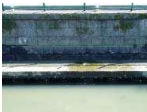
写真 2-2 護岸からの浸出水の状況（諏訪橋上流右岸）
