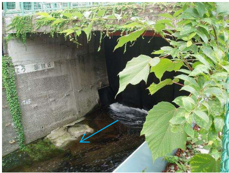
JR総武線馬喰町駅～東京駅からの地下水の導水（品川区）
