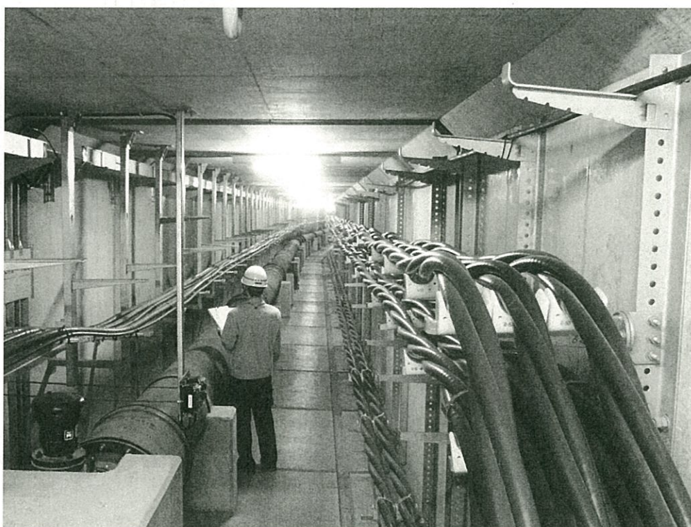
立川共同溝内部
