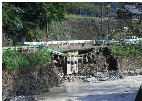
写真-1 被害状況(陣馬街道・道路護岸の崩落)
