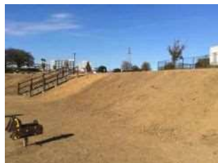
法面が崩落し、土砂の流出が発生
