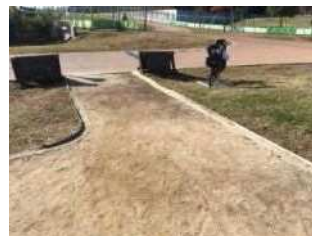
既設土留めは高さが低く、踏く恐れがあった そのため、馬看板を踏き防止用に設置していた
