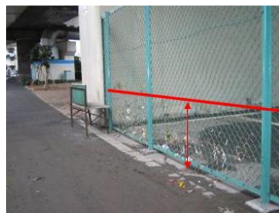
平成11年集中豪雨冠水痕跡（明治通り）
