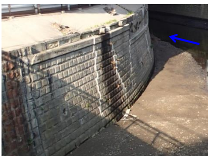
護岸の老朽化（古川）
