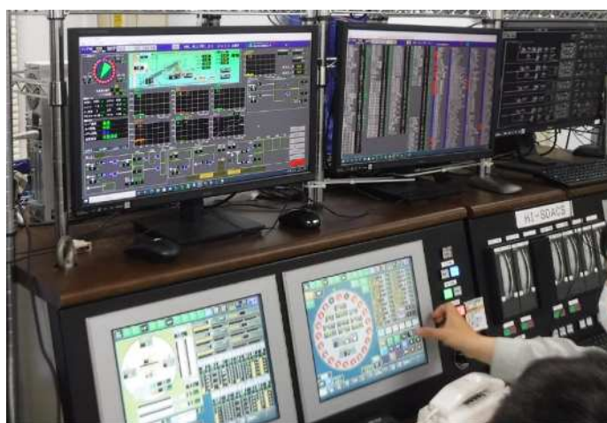
シールドマシン中央制御室
