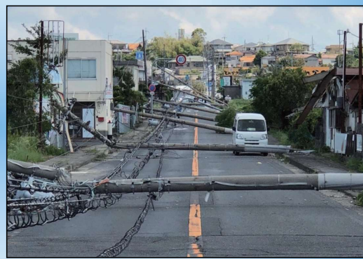
平成30年台風第21号(大阪府泉南市)
