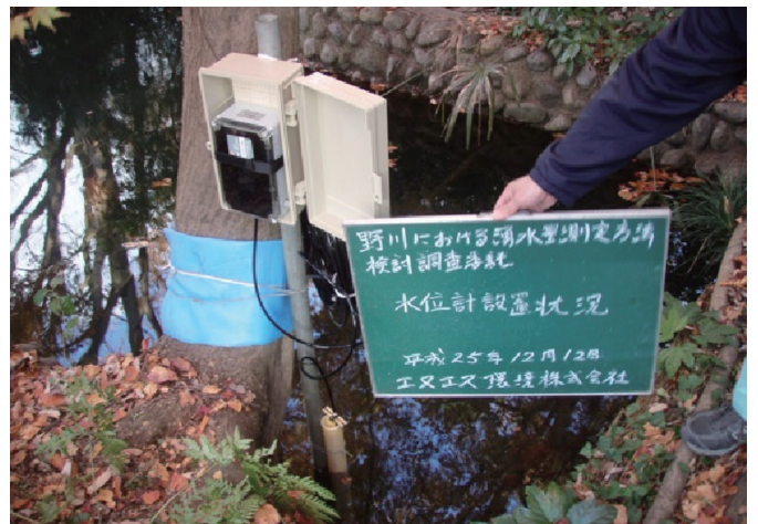
水路上流側の自記水位計
