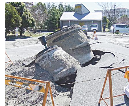
マンホールの浮上被害事例 (東日本大震災 浦安市 H23)
