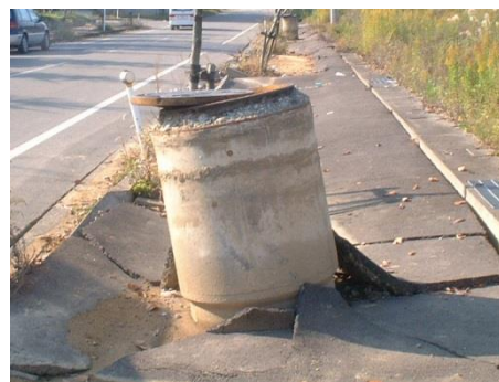
マンホールの浮上被害事例 (新潟県中越地震 H16)
