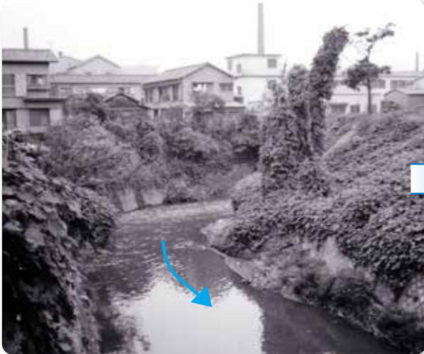
川幅が狭く土砂が堆積している状況
