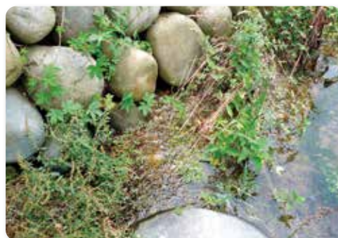
空石積護岸の隙間からの湧水
