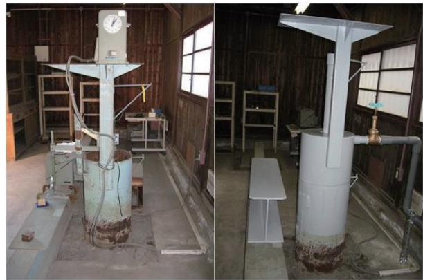
写真-1 戸田橋第 1 観測井の自噴対策
