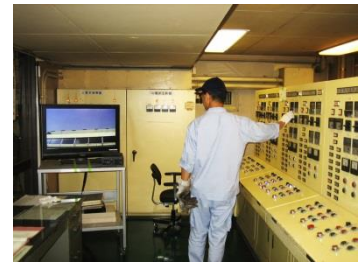
排気口監視モニターチェック
