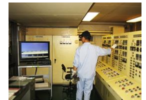
排気口監視モニターチェック
