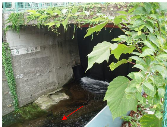
写真 2-2 総武線の馬喰町、東京駅にろう出している地下水導水の様子（月見橋）
