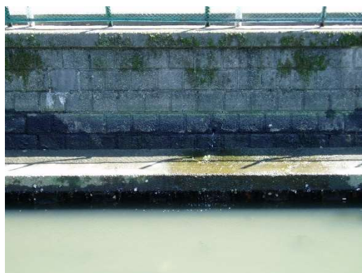
写真 2-2 護岸からの浸出水の状況（諏訪橋上流右岸）
