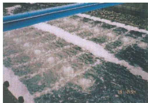
（水質浄化装置稼働状況）
