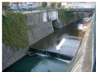
写真 4.10 水生生物の移動を妨げる落差工 (真光寺川)
