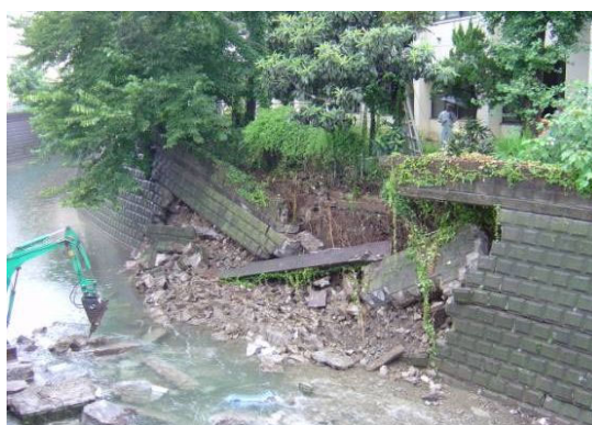
三谷橋上流（妙正寺川）の被害状況 H17.9
