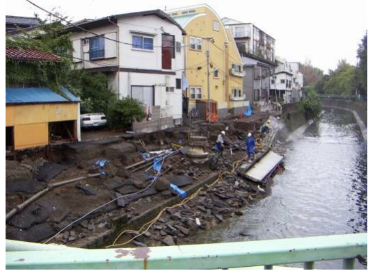
北原橋上流（妙正寺川）の被害状況 H17.9
