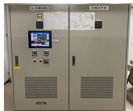
インバータを含む制御盤 （管理棟内）
