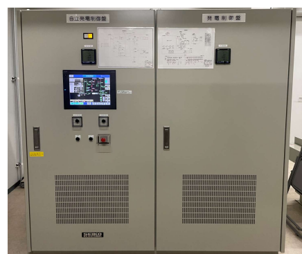
インバータを含む制御盤 (管理棟内)
