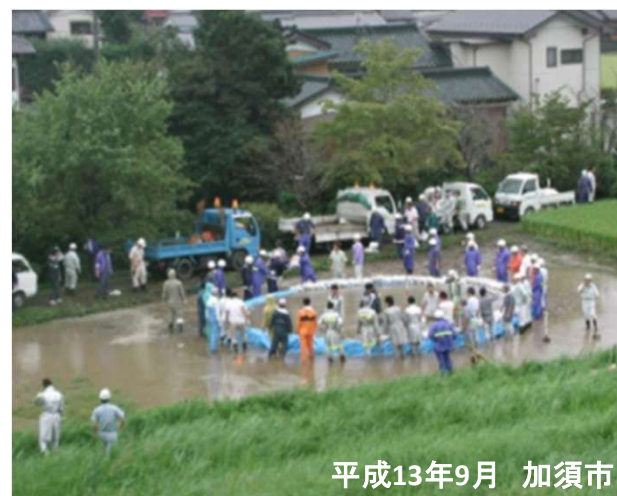
洪水により発生した漏水を 水防活動により対策
